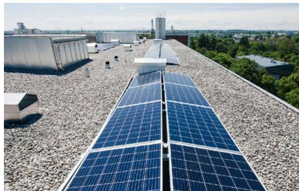
Moderne Photovoltaik auf dem Dach macht die Nutzung erneuerbarer Energien einfach.
